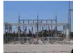
Figura 40 – Vista do parque de Muito Alta Tensão.
