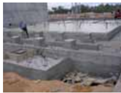
Figura 23 – Maciço de assentamento de transformador.
