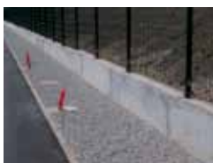
Figura 33 – Vedaçao da subestacao.
