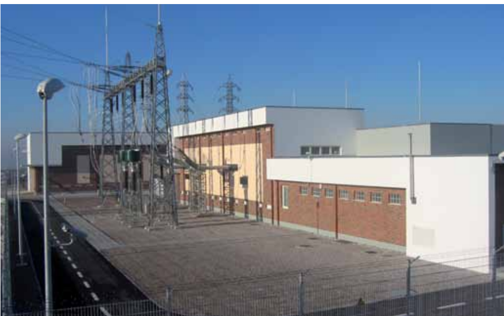
Figura 4 – Fotografia de uma Instalação Blindada (GIS – Gas Insulated Substation ) – vista exterior.
