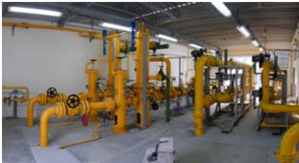
Estação de Regulação e Medida (GRMS)
