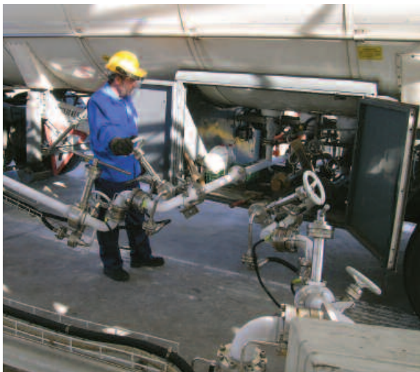
Carregamento de cisternas
